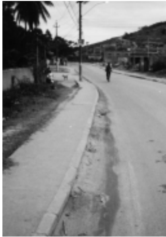
Logradouro necessitando raspagem de terra na sarjeta
