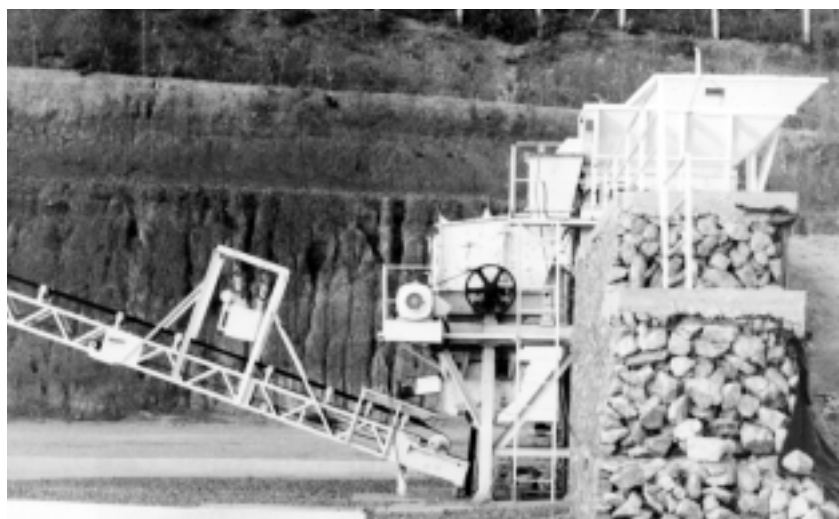
Usina de Reciclagem de entulho de B.H. – Alimentador e triturador
